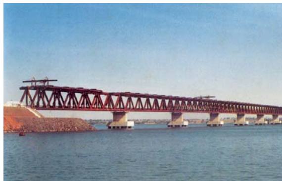
Ponte rodoferroviária sobre o rio Paraná, entre Santa Fé do Sul e Aparecida do Taboado, na época da construção (divulgação Ferronorte)
