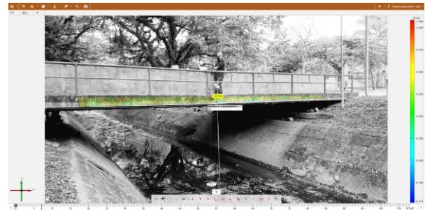
Fig. 9 Ensaio DIC realizado no tabuleiro de uma OAE
