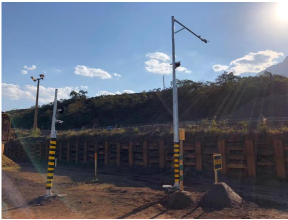
Fig. 6 Instalação em Fazendão
