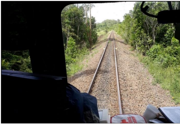
Foto 7 - De dentro do veículo auto de linha é possível avistar a localização da canaleta com facilidade.
