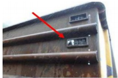
Figura 10 – Dreno de cabeceira avariado.
