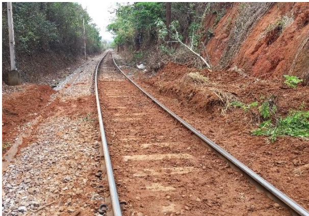
Fig. 2 Deslizamento ocorrido em 04/Out/2017 no km 599,124.
